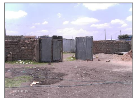
Defektes Tor in Kariobangi
